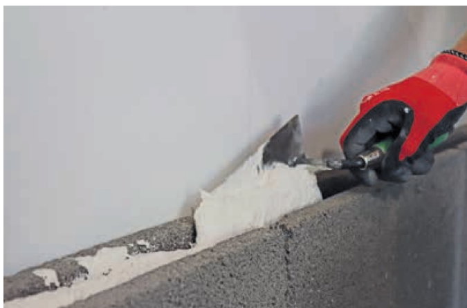
Posare i Lecalite utilizzando Rasatutto (o Rasatutto OK) a consistenza collante, applicato nell'incavo orizzontale con la cazzuola.
